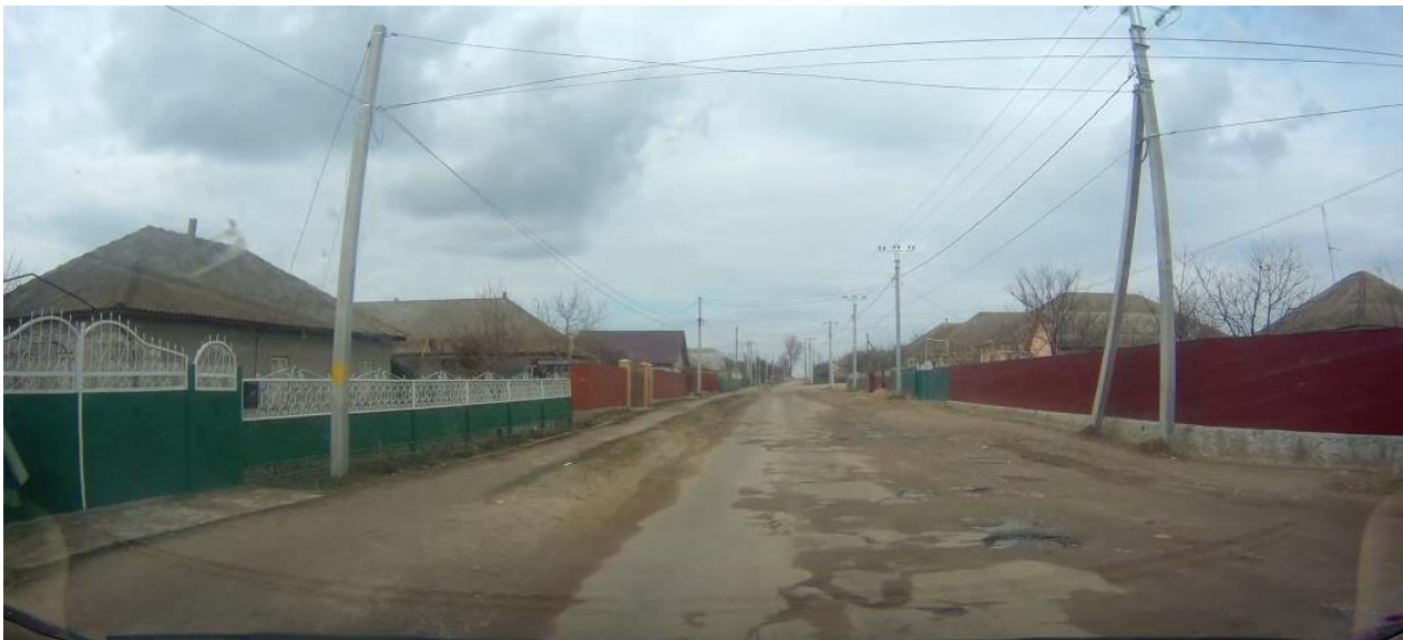
Покрытие в плохом состоянии (L637 М3 – Вулканешты -Вадул луй Исак, км2)
