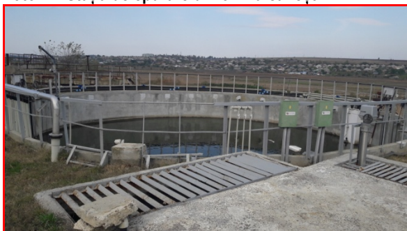
Foto 12 Stația de epurare din or. Vulcănești
