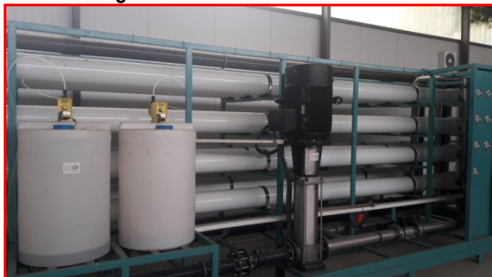
Foto 7: Stația de tratare a apei (proiect TIKA) din mun. Ceadâr-Lunga
