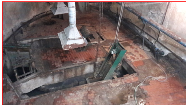
Foto 3: Stația principală de pompare a apelor uzate din mun. Comrat
