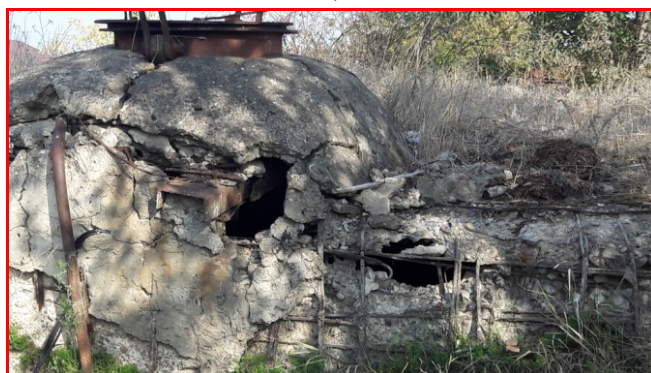
Foto 4: Rezervor de apă nefuncțional din mun. Comrat
