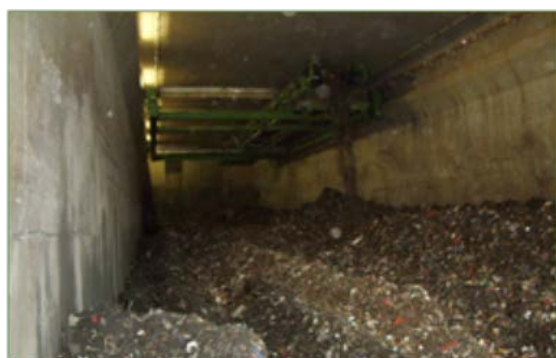
Interiorul tunelurilor de compostare
