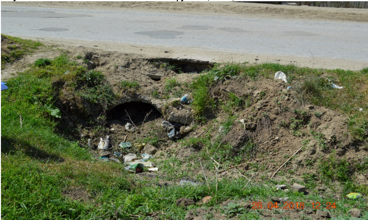
Рисунок 3. Заиливание значительной части сооружения, Км 13,600.
