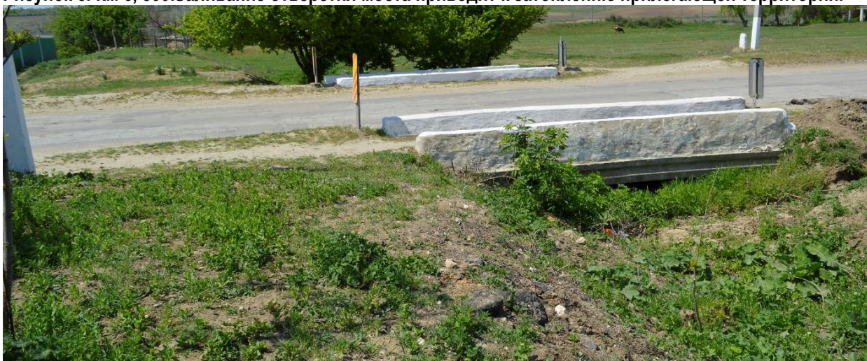
Рисунок 5. Км 6, 800.Заливание отверстия моста приводит к затоплению прилегающей территории.
