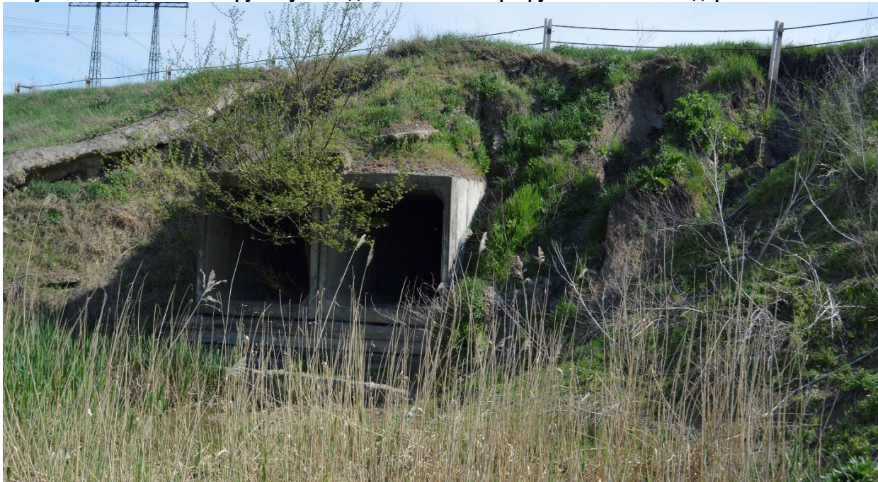
Рисунок 1. Км 3,90 Размыв русла у выходного оголовка с разрушением полотна дороги.
