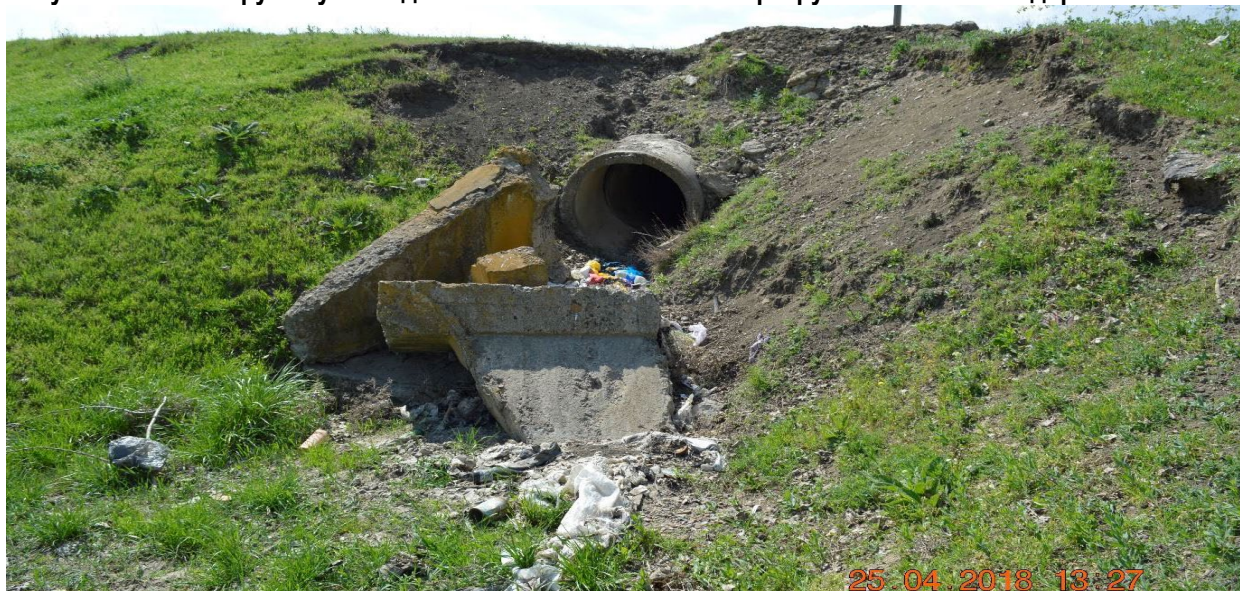
Рисунок 3. Размыв русла у выходного оголовка с частичным разрушением полотна дороги.
