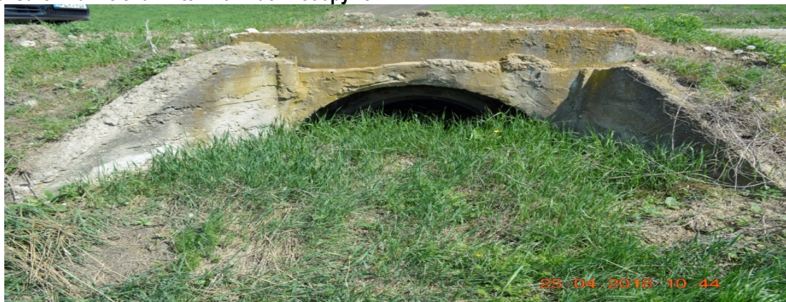
Рисунок 3. Заиливание значительной части сооружения
