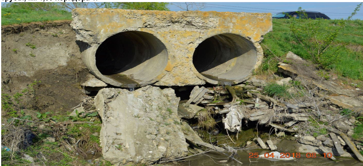
Рисунок 5. Размыв у выходного оголовка с частичным разрушением земляного полотна у водопропускной трубы, км 1,80 Коридора 1.
